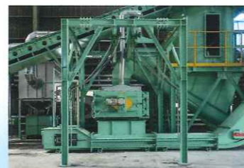
▲RPF製造設備
