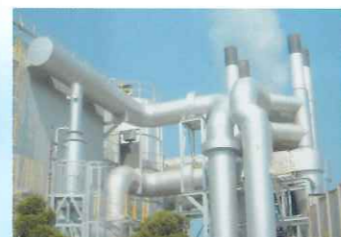
▲産業廃棄物焼却処理プラント
