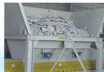
▲石膏ボード処理プラント
