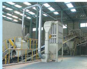
集塵装置 破碎時に生じる微粉じんを除去
