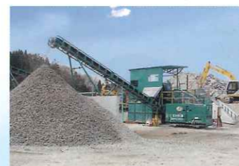
▲再生砕石プラント(がれき類処理)
