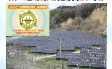
太陽光施設 本所向かいに750kwのソーラーパネルを設置エネルギーの地産地消に協力しています。
